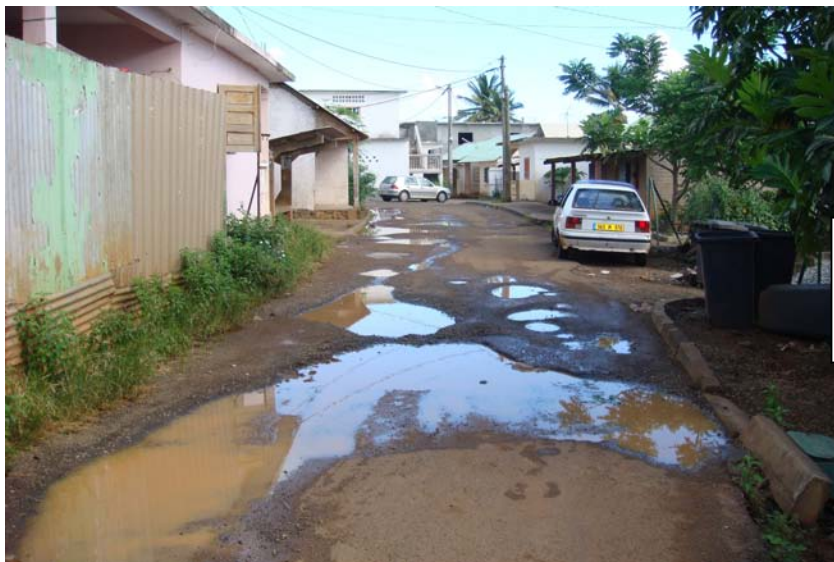
Stagnation eaux pluviales sur voirie
