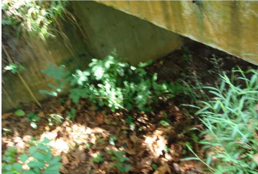
Une buse remplie de déchets
