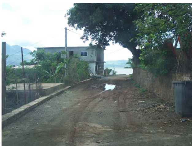
Doc. 63 – Une voie fortement dégradée dans le village de Bandrélé. Crédit photographique - BET TEMA, 2008.
