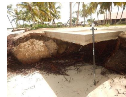
Erosion sous une dalle de béton d'environ 90 cm novembre 2020
