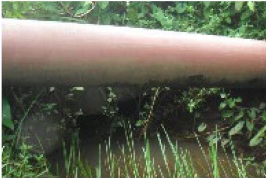
Ouvrage type buse sous-dimensionnée, Soula 1 aval talweg D. Photo issue de l'étude d'impact AGIR, mars 2018
