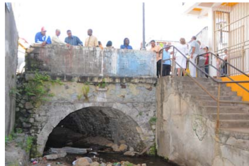
Source : maximini.com Ouvrage hydraulique de la ravine Billaud qui menace de s'effondrer
