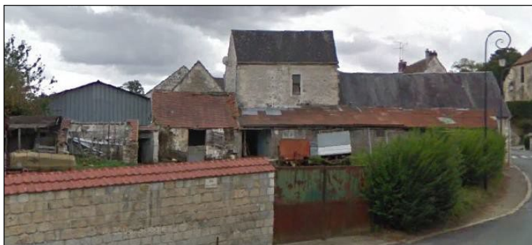
5) L'aspect dégradé des annexes
