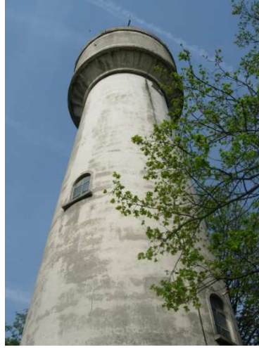
Réservoir de Boisemont 75m 3
