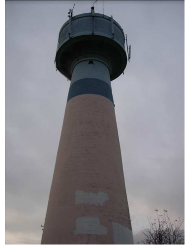
Réservoir de Courdimanche 250m 3
