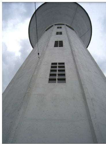
Réservoir de Saint-Ouen- l'Aumône rue d'Epluches 500 m 3
