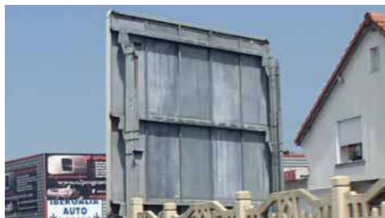
DÉFAUT D'HABILLAGE DU DOS
