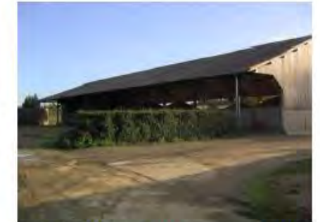
Ancien hangar en bois en partie reconstruit. Suite à l'effondrement d'une travée.
