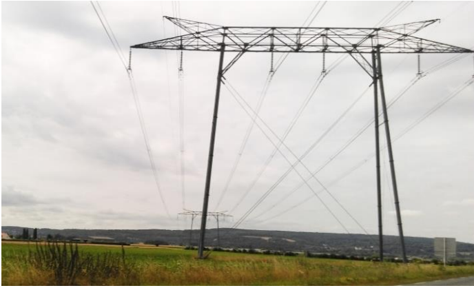
Lignes à Haute tension
