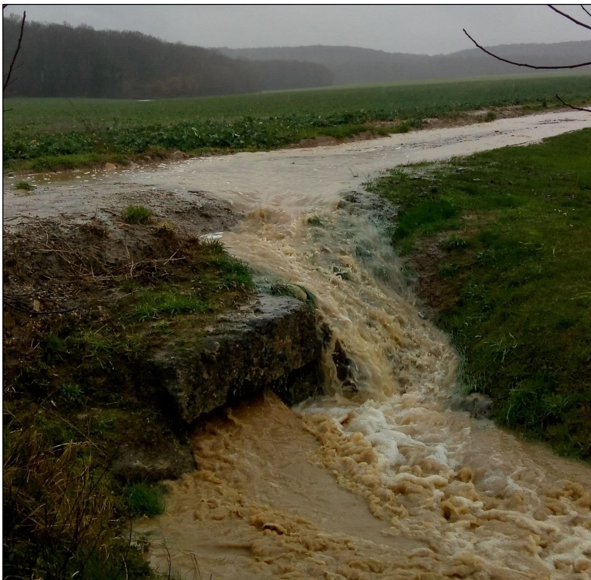
Figure 5.9 : Ruissellement sur le chemin des Groseilliers se déversant à l'aval du passage en buse (photo fournie par la commune)
