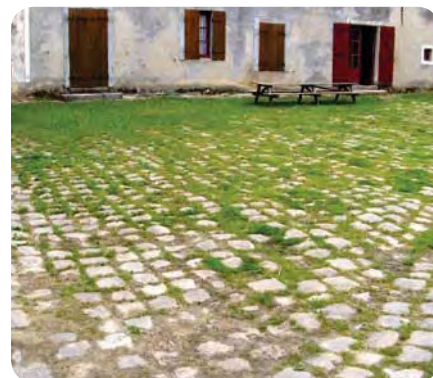
LES PAVÉS SANS JOINT LAISSENT S'INFILTRER L'EAU
