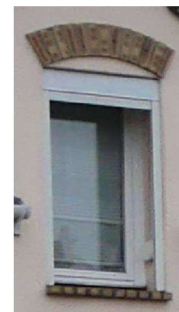
Des éléments rapportés en façade qui ne reprennent pas une logique constructive / un effet pastiche
