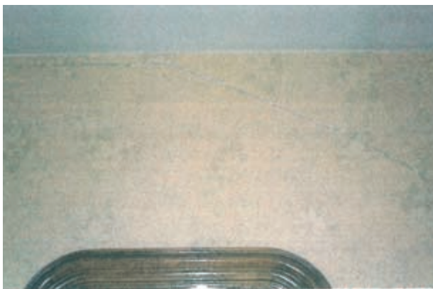
Fissuration intérieure, tapisserie déchirée - Maison André.
