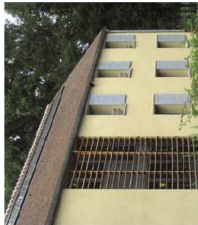
Un ensemble de capteurs thermiques soigneusement intégré à la façade. © PIR Haute-Voie de Chevroux
