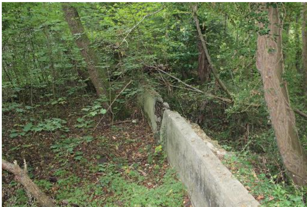
Photo de la partie nord du bassin du Baratage (mur avec brèches)
