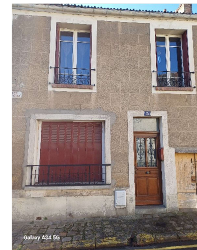
Modification de baie au RDC à proscrire
