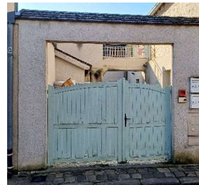
Proportions du portail ne correspondant pas aux dimensions de la baie d'origine ménagée dans le mur de clôture
