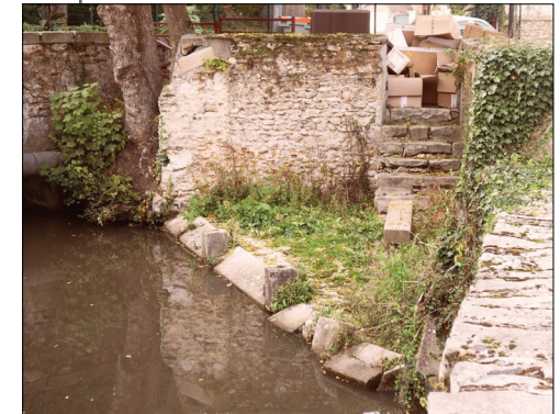
LAVOIR OUVERT ALTÉRÉ (MARGELLE DE RIVE DÉGRADÉE)
