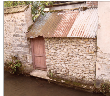
LAVOIR COUVERT ALTÉRÉ (COUVERTURE DISPARUE, OUVERTURE BOUCHÉE)
