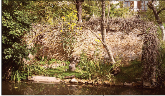
LAVOIR COUVERT ALTÉRÉ (COUVERTURE DISPARUE, MAÇONNERIE ET MARGELLE DÉGRADÉE)
