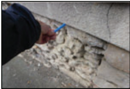
ÉPAISSEUR DE 6 CM CONSTATÉE SUR CETTE FAÇADE
