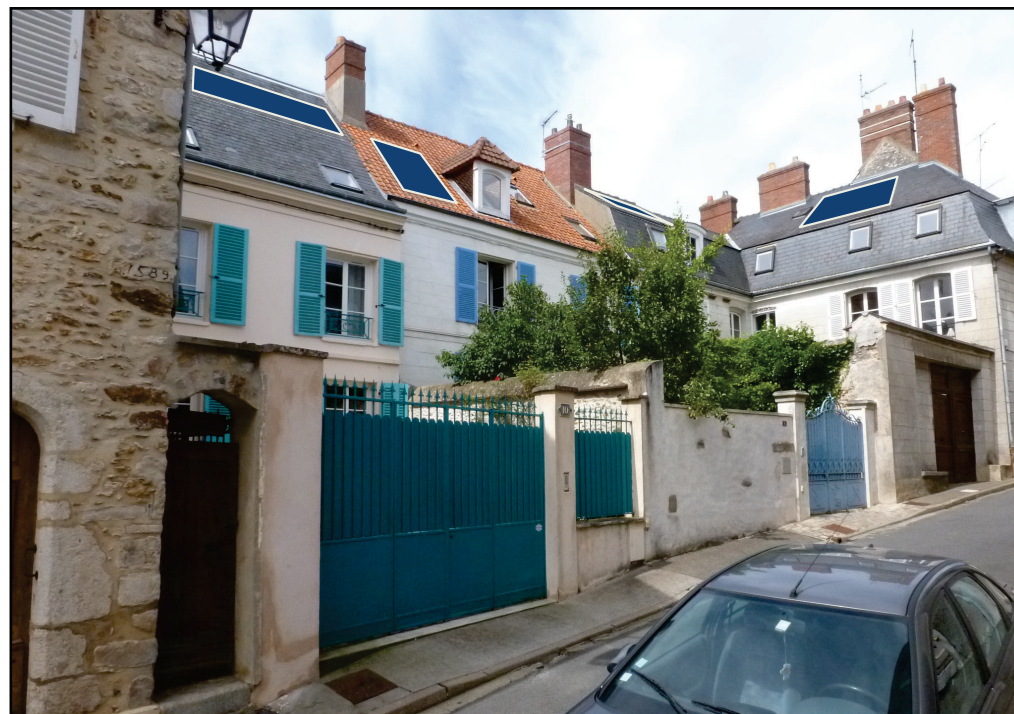
MAUVAISE INSERTION DE PANNEAUX SOLAIRES SUR DU BÂTI ANCIEN
