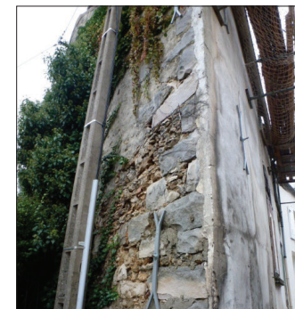
PIGNON DE TYPE 2 ENDUIT À PIERRES VUES TRÈS DÉGRADÉ SUR UNE MAISON RURALE
