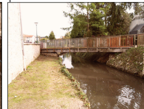
PASSERELLE DU CENTRE CULTUREL (RUPTURE DU PASSAGE)
