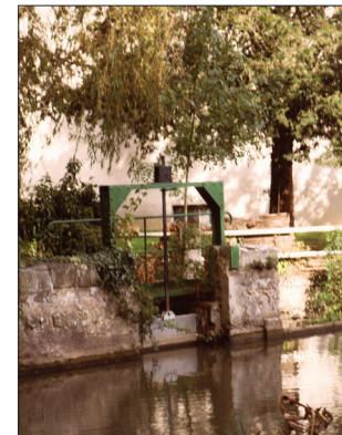
VANNE DE DÉCHARGE
