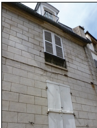
FAUX CALEPINAGE EN ENDUIT
