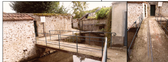
PASSERELLES DE LA PROMENADE VENEAU (MAUVAIS ÉTAT DE CONSERVATION DU TABLIER DE LA PASSERELLE)
