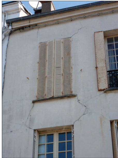
TROP FORTE RIGIDITÉ DES ENDUITS CIMENT
