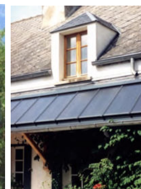
Les capteurs s'intègrent dans les protections solaires
