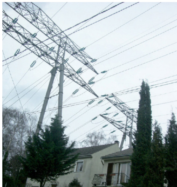
Les lignes à haute et très haute tension, au dessus des habitations - 05/2011
