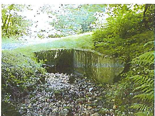
Photo MC 615: vue amont de l'ouvrage n°28 Tendance aux dépôts de sédiments
