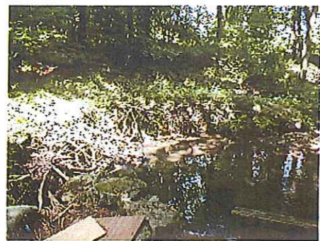
Photo 323 : érosion ouvrage de prise
