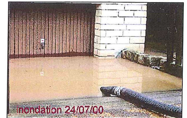
Photo 43: garage inondé av. de Coubertin
