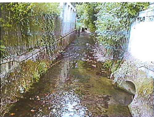
Photo 201 : rejet EP rive droite
