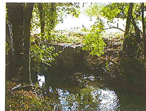
Photo 300 : rejet rive gauche
