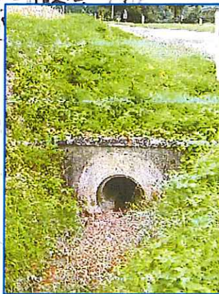
BOU5: entrée collecteur D500
