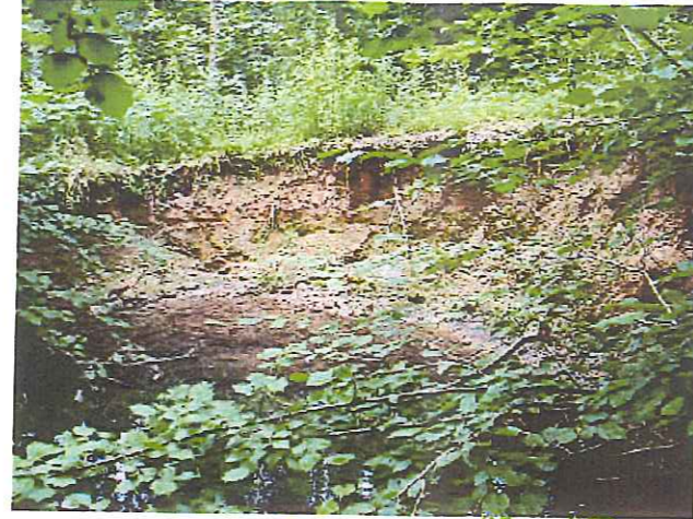
Photo MB 410 : érosion
