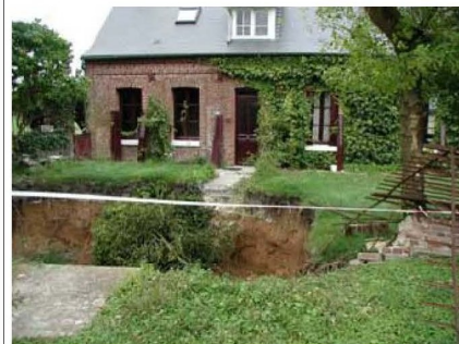
Conséquence d'un affaissement (Somme) – (Source : BRGM)
