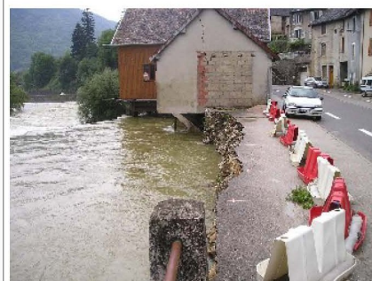
Érosion de berges à Lods (25) - 2006 (Source DLA)
