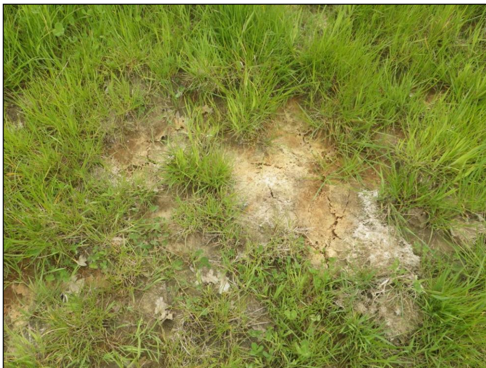
Figure 31 : traces de stagnation d'eau sur la butte - source : IAD 2018.
