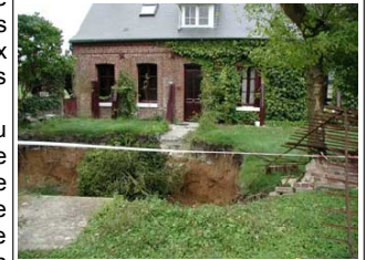
Conséquence d'un affaissement (Somme) – (Source : BRGM)
