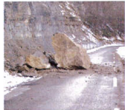
Éboulement d'un rocher le 02/12/2009, Plaimbois-(25) – (Source gendarmerie)
