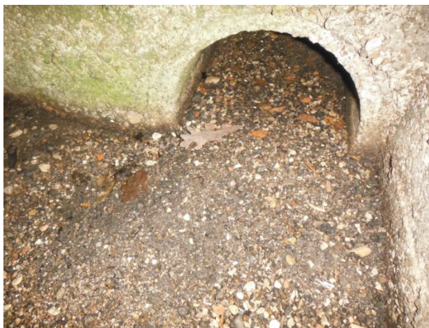
Source : Altereo, 2019. Figure 15 : Exemple de réseau encombré par des sédiments.
