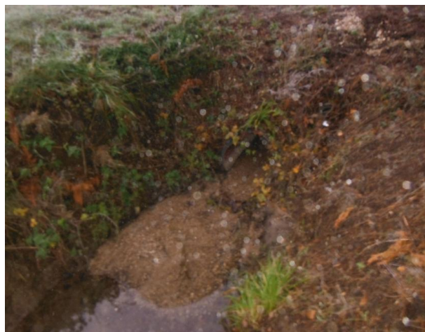
Source : Altereo, 2019. Figure 16 : Exemple d'exutoire encombré par des sédiments.
