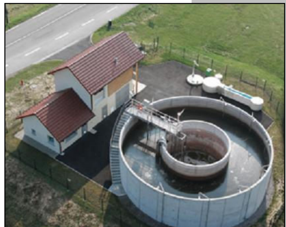
Station de traitement des eaux usées de RUPT-SUR-MOSELLE
