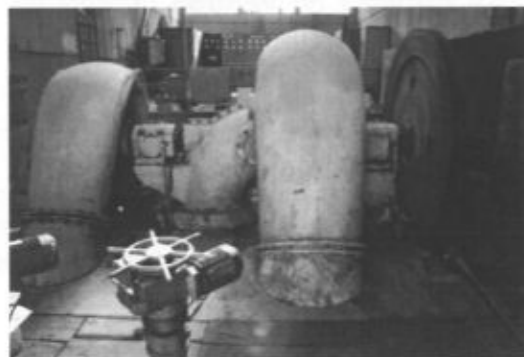
Turbine du Saulcy.
