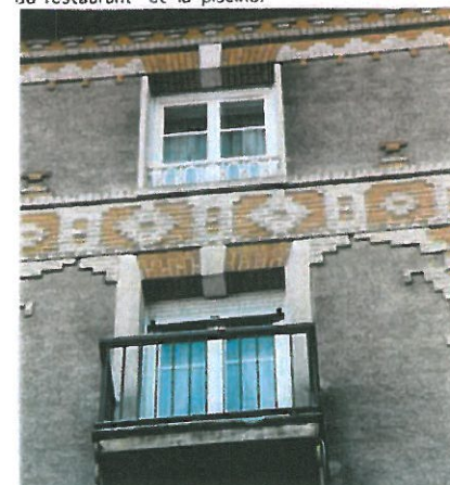
Réhabilitation satisfaisante de l'Hôtel Cosmos : Mise en valeur de la modénature en briques. Caissons des volets roulants non visibles.
