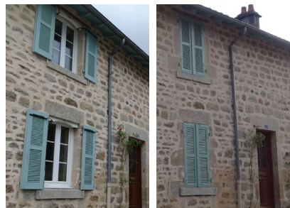
Système de volets électriques dans le respect de la qualité patrimoniale de la construction (Peyrat)
