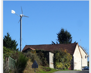
Exemple d'éolienne d'autoconsommation (Saint-Laurent les Églises)
