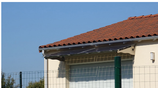
Bonne intégration des panneaux solaires en casquette de la fenêtre et du volet roulant où le caisson n'est pas invisible en façade
