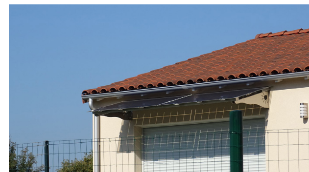
Bonne intégration des panneaux solaires en casquette de la fenêtre et du volet roulant où le caisson n'est pas invisible en façade
