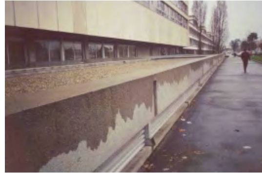
Aménagement en décroché de toiture-terrasse sur site hospitalier Source CETE du Sud-Ouest
