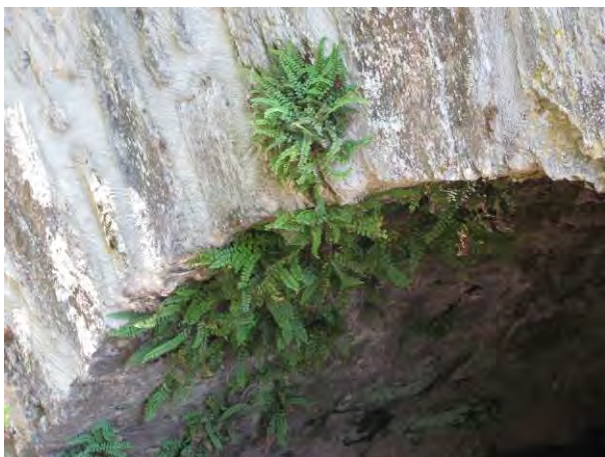
Capillaire des murailles (pont de la RD 57 sur le ruisseau de Marsaguet)
