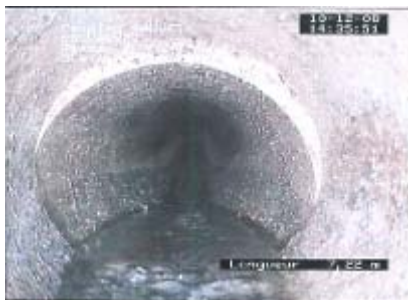
Photo 1 : déboitement de la canalisation
