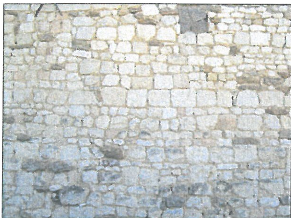
Mur en moellons de tuffeau de forme carrée, avec des pierres granitiques implantées à intervalles réguliers.
