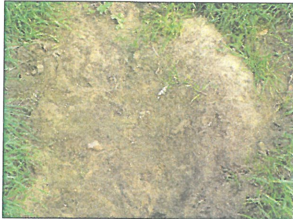
Sable dans un fossé de la commune
