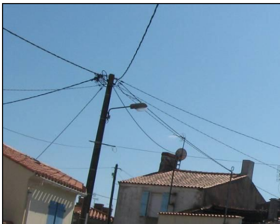
Réseau électrique aérien – village de la Guittière
