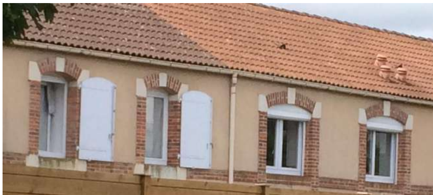
Le volet roulant vient accentuer l'isolation hermétique de l'huisserie et appauvrit la façade et la qualité architecturale du linteau.
