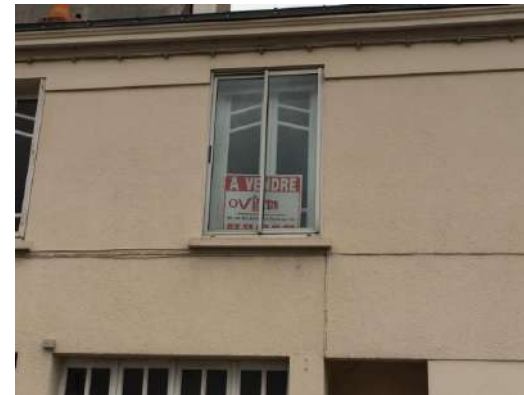
Double fenêtre à l'extérieur – à éviter Pour des questions esthétiques.
