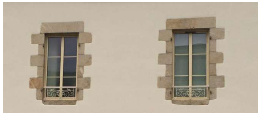
La disparition des persiennes appauvrit la façade
