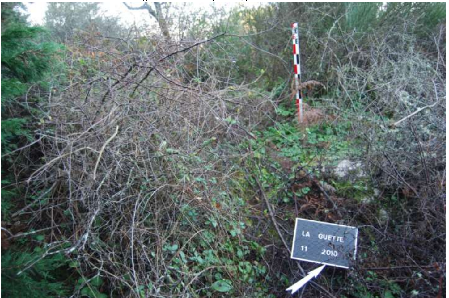
Figure 6 : vue d'ensemble, dolmen envahi par la végétation
