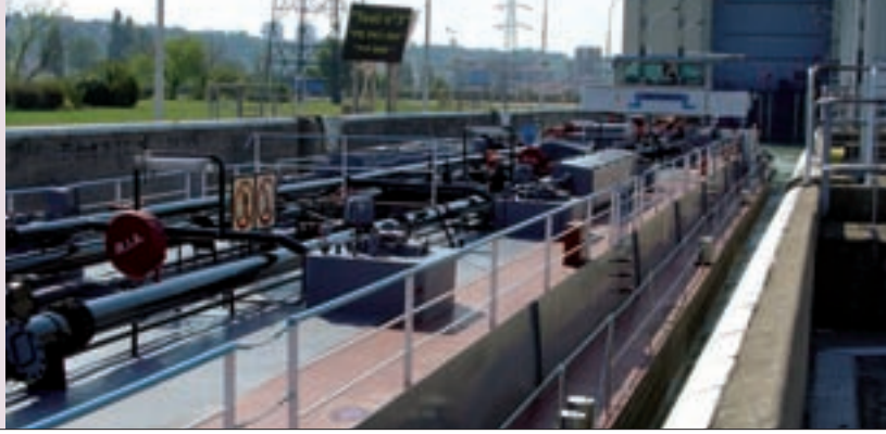
Écluse, transport d'hydrocarbures par voie fluviale – automateur Odysseus (Ph. Robin, SNRS)
