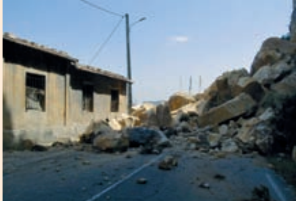
Éboulement sur la RD26 près de Mondragon (DDE 84)
