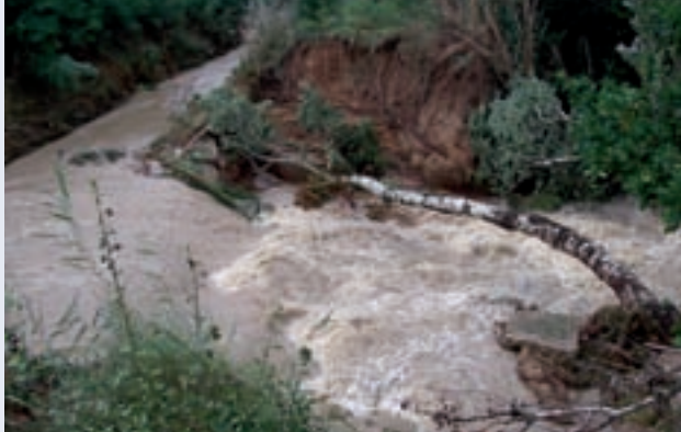
Rupture de la digue de la Grande Levade, septembre 2002 (DDAF 84)
