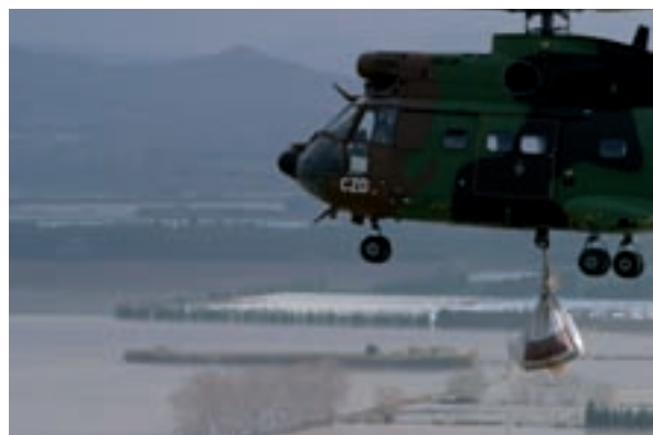
Un hélicoptère Puma de l'armée de terre colmate une brèche dans la digue du Rhône (Service des Armées)
