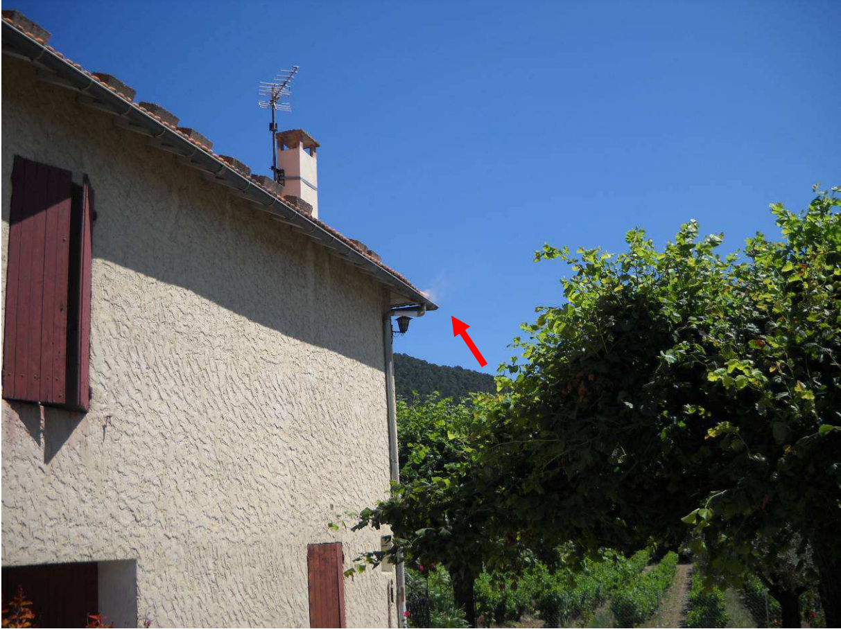
11- Route Départementale n 23, Quartier la combe, Mme JOURDAN-MOLLARD Jocelyn : chéneau se jette dans le réseau d'eaux usées : 40 m2.
