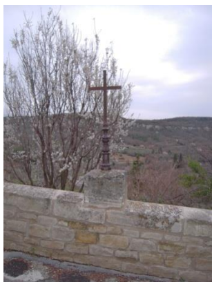
Croix sur le mur de bord de route, rue du quai Le mur a été repris en 2015
