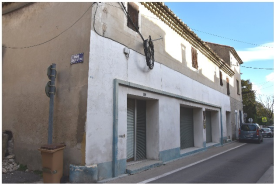
Rupture architecturale entre RDC et 1er niveau
