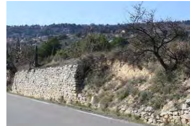
Mur écroulé en bord de RD 2
