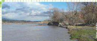
Digue des Rayons à Pertuis (12) et son état après la crue de novembre 2008.
