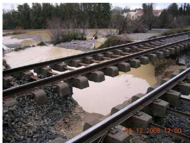
Rupture d'un remblai ferroviaire crue du Coulon le 15/12/2008
