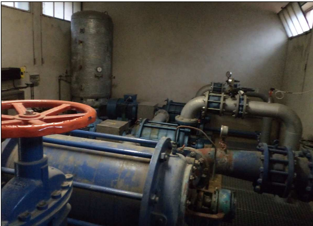
Figure 4-35 : Ensemble des pompes dans la station de La Gardy
