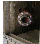
Bouche d'aspiration de 100 mm sur une réserve d'eau enterrée
