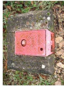
Bouche de lavage fermée
