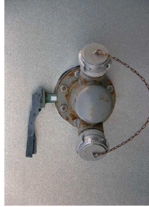
Prises directes de 100 mm sur réserve d'eau incendie aérienne
