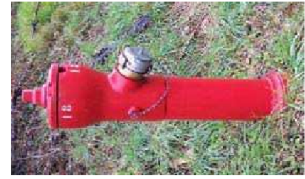
Poteau Incendie de 80mm avec une sortie de 65mm
