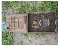
Bouche Incendie de 80 mm à tenons
