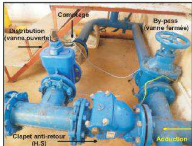
4. Vue intérieure de la chambre de vannes
