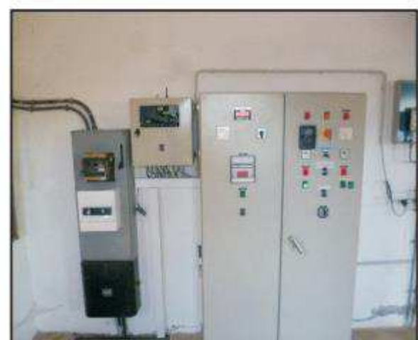
6. Vue intérieure de la station de surpression armoire électrique et télésurveillance
