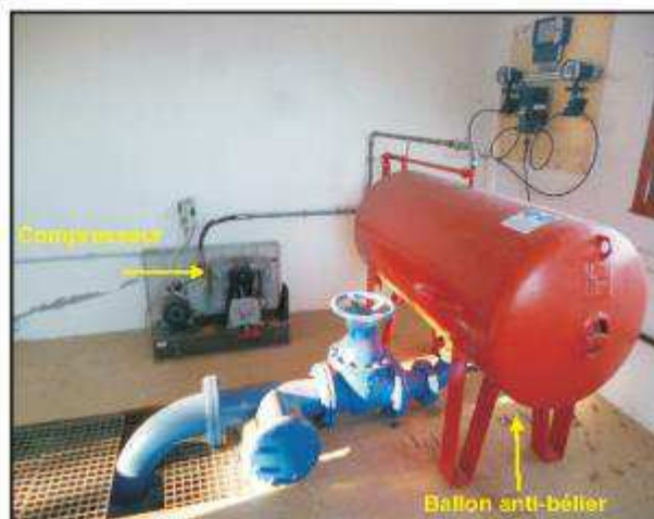
5. Vue intérieure de la station de surpression ballon anti-bélier
