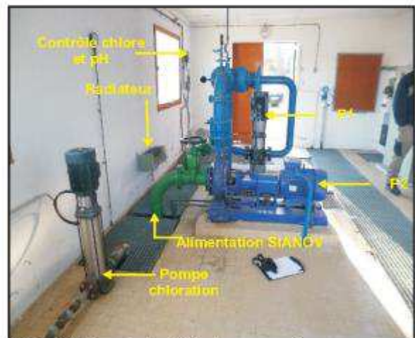
4. Vue intérieure de la station de surpression
