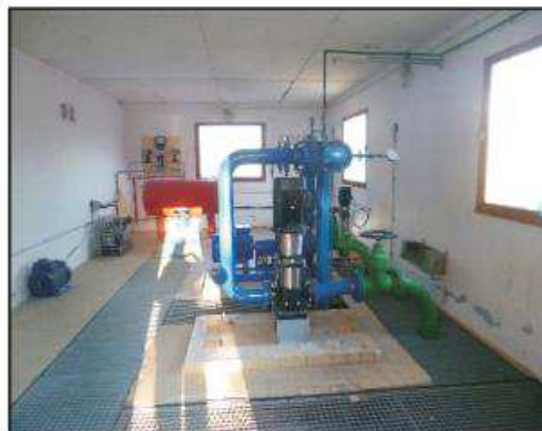
3. Vue intérieure de la station de surpression
