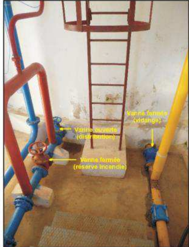
2. Vue intérieure de la chambre de vannes
