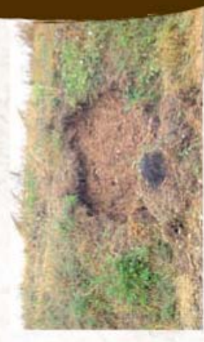
Erosion du talus due au manque de végétation pour retenir la terre.
