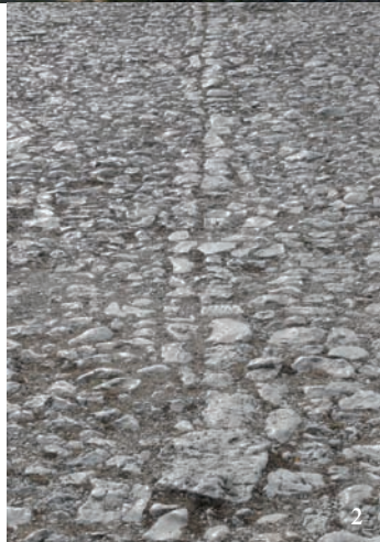
1. Pas d'âne à emmarchement en pierre de taille et calade centrale en galets du Colostre (Saint-Martin-de-Brômes) 2. Aire de Saint-Bayons (Comps-sur-Artuby)
