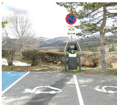
↑ Borne électrique sur le parking public mutualisé.
