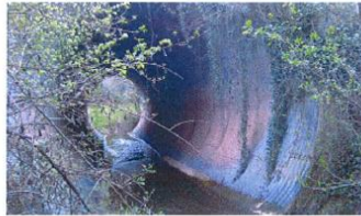
Photos 18 : L'ouvrage de la décharge du Vallon des Déguiers sous la RD125
